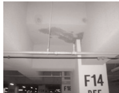
↳ 지하주차장 지하5층 천정 누수
