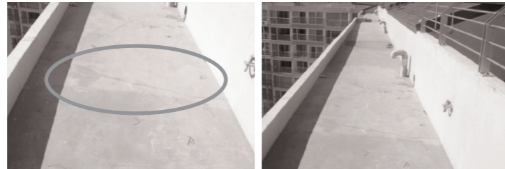
↳ 옥상 배수로 바닥 균열부위 전경
