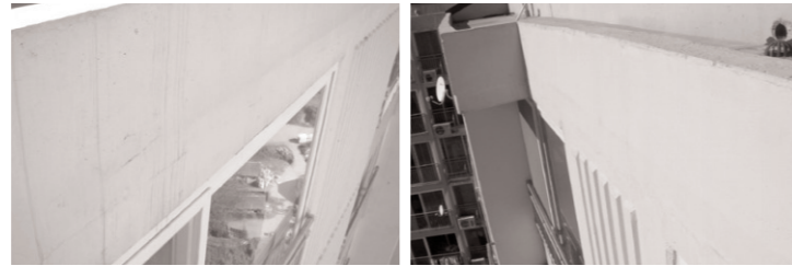
↳ 옥상 파라펫 균열부위 전경
